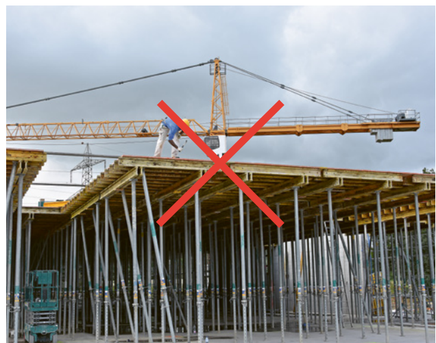
2 Verboten: Deckenschalung ohne Absturzsicherung bei grosser Absturzhöhe.
